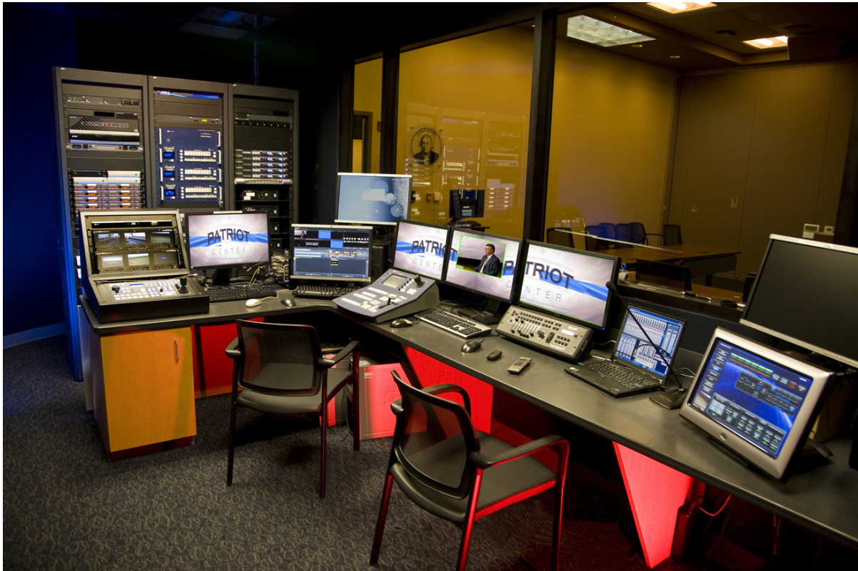
Régie de l'auditorium du nouveau Patriot Center – Lockheed Martin Space Systems Company, Newtown, Pennsylvanie - USA
